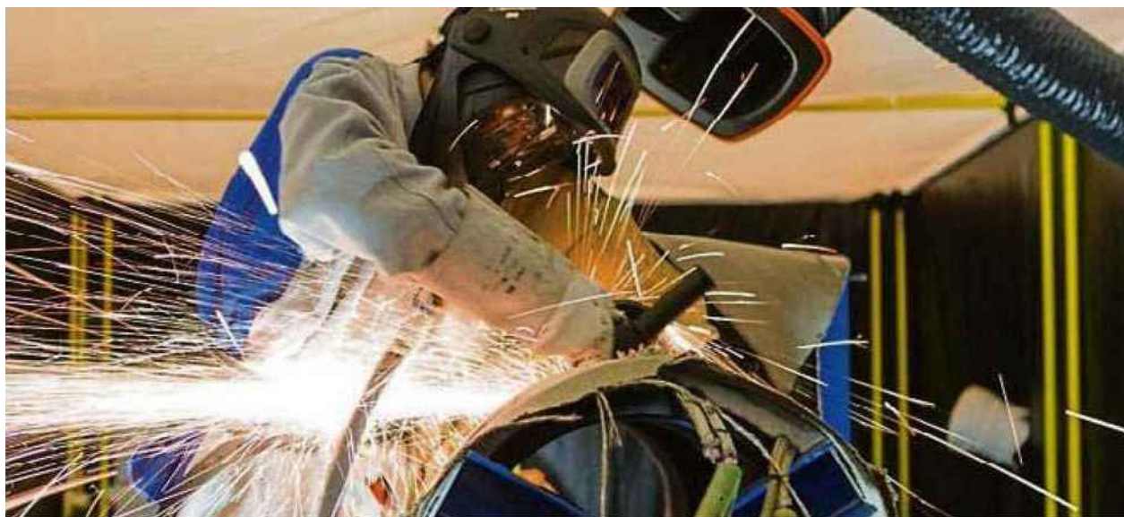
Le grand carénage est un programme de maintenance des centrales d'EDF, destiné à prolonger la durée d'exploitation des réacteurs au-delà de quarante ans. Photo Marc Caraveo/EDF
